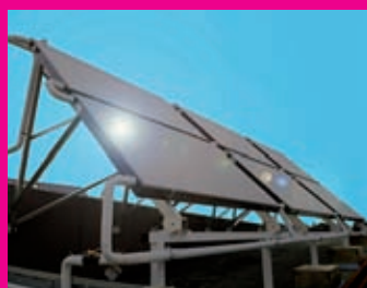
Chauffe-eau solaire p. 9 Une aide de la commune
