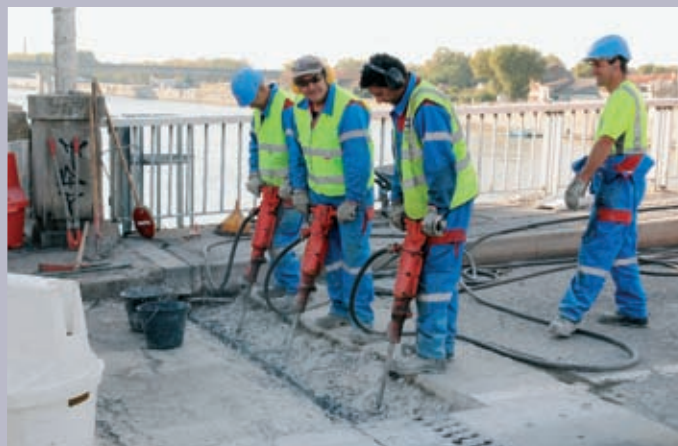
On achève les travaux de remise en état sur le joint du pont de Trinquetaille
