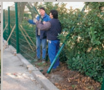
Sécurisation des équipements sportifs : pose d'une clôture neuve le long du stade Fournier.
