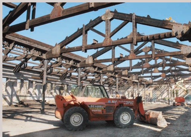
Une fois l'ancienne couverture enlevée, une toiture moderne sera posée à l'atelier des roues
