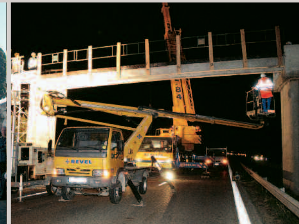
Le tablier du pont endommagé au-dessus de la quatre-voies a été posé de nuit, le 18 octobre
