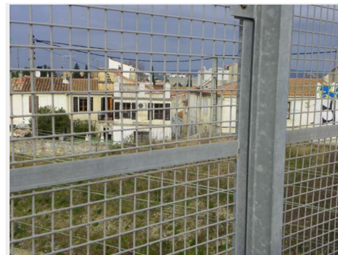
Un garde corps qui obstrue la vue
